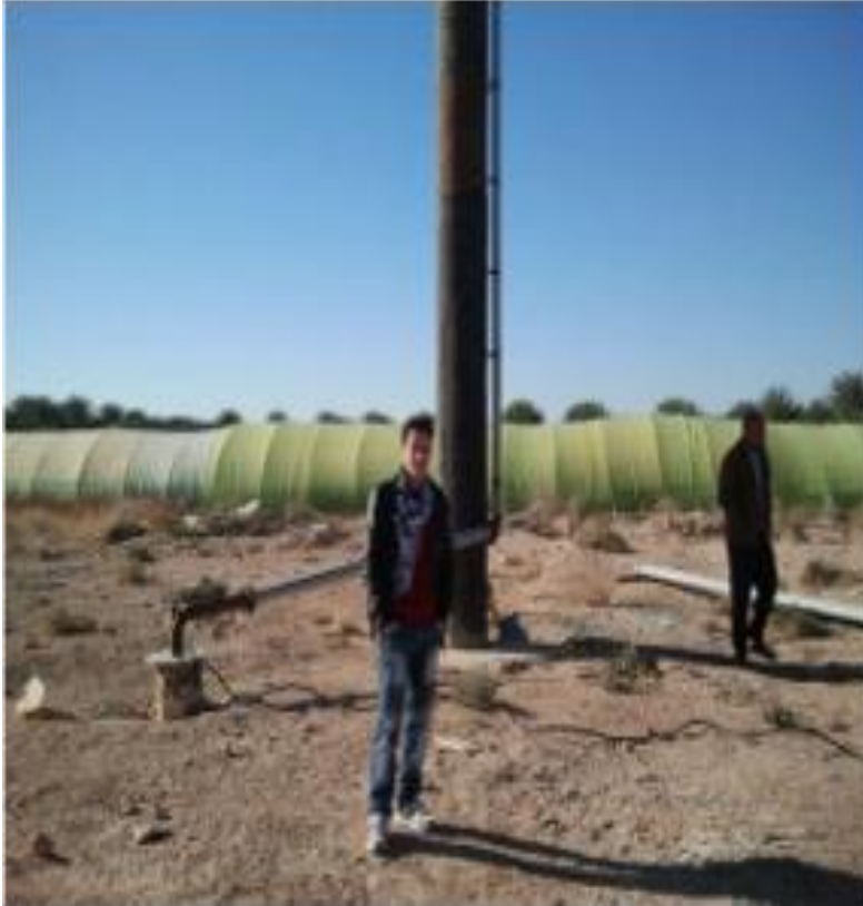
Figure 3a. Dispositif de château d'eau en amont du réseau d'irrigation
